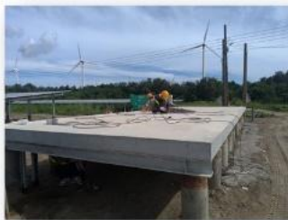
單元升壓站建置
